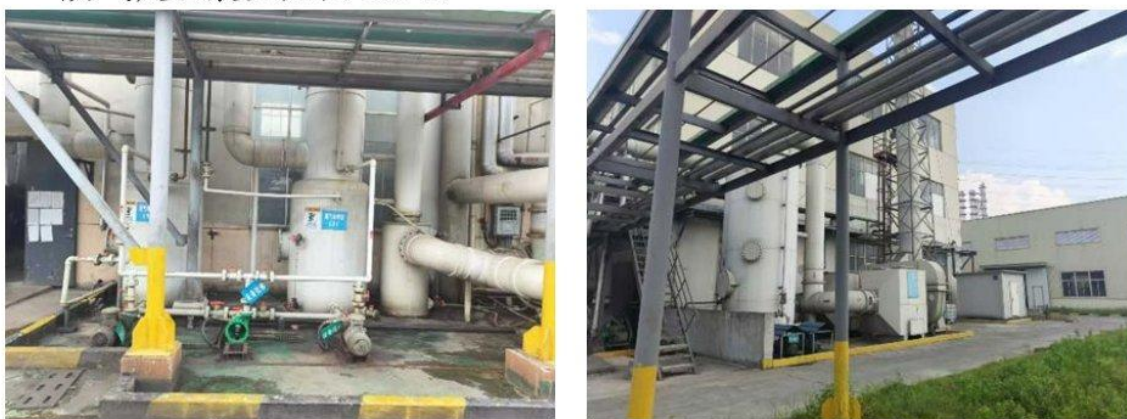
图3.5-1 废气处理装置
